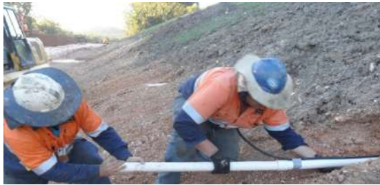
รูปที่ 4.3 ท่อระบายน้ำแนวราบ ด้านบน : ท่อระบายน้ำแนวราบต้องมีระยะห่างเกินระนาบวิกฤติด้านล่าง : ขณะติดตั้งท่อระบายน้ำแนวราบ (ที่มา : www.shotcreteconcrete.com )
