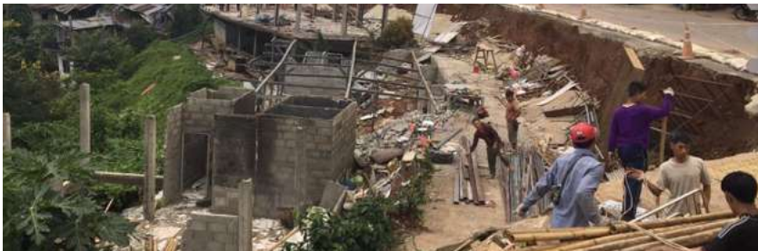
รูปที่ 2.20 ร่องรอยดินถล่มตามถนนสายหลักย่านชุมชนดอยแม่สลอง บ้านสันติคีรี ตำบลแม่สลองนอก อำเภอแม่ฟ้าหลวง จังหวัดเชียงราย (ที่มา: www.brighttv.co.th และ www.thairath.co.th )
