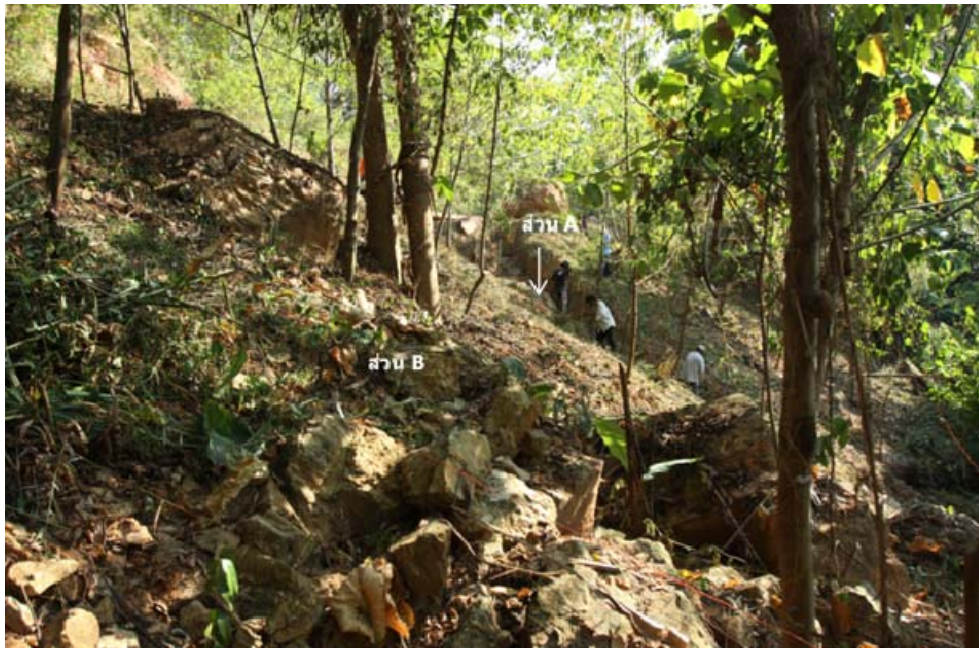
ภาพที่ 4.14 ลักษณะความเสียหายของพื้นที่ดำเนินงานส่วนที่ 1 ที่เกิดการกัดเซาะผิวหน้าดินแต่ไหล่ถนนยังคงสภาพความลาดชันเดิมไว้ได้ เนื่องจากมีรากต้นไม้เป็นส่วนสำคัญในการยึดดิน
