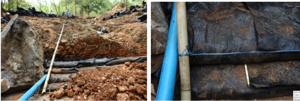
ภาพที่ 4.32 การวัดแนววางกระสอบมีปีกในแต่ละชั้น ระยะห่าง 15 เซนติเมตร
